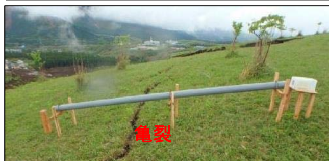
⑤熊本県南阿蘇村高野台地区の亀裂 （亀裂の幅を計測する伸縮計を設置）
