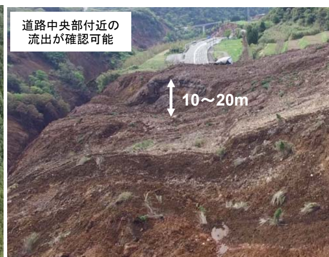
土砂流出状況 (撮影4/16 阿蘇大橋地区付近)
