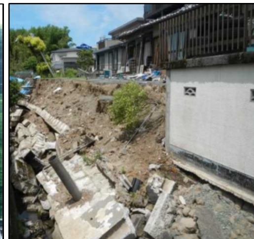
人工斜面崩壊状況（熊本県益城町）
